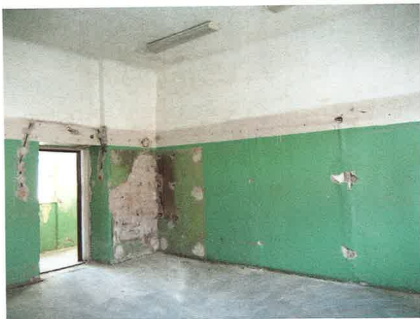
Foto č. 25 : Východné krídlo, 2.NP, m.č. 2.09, severozápadný kút
