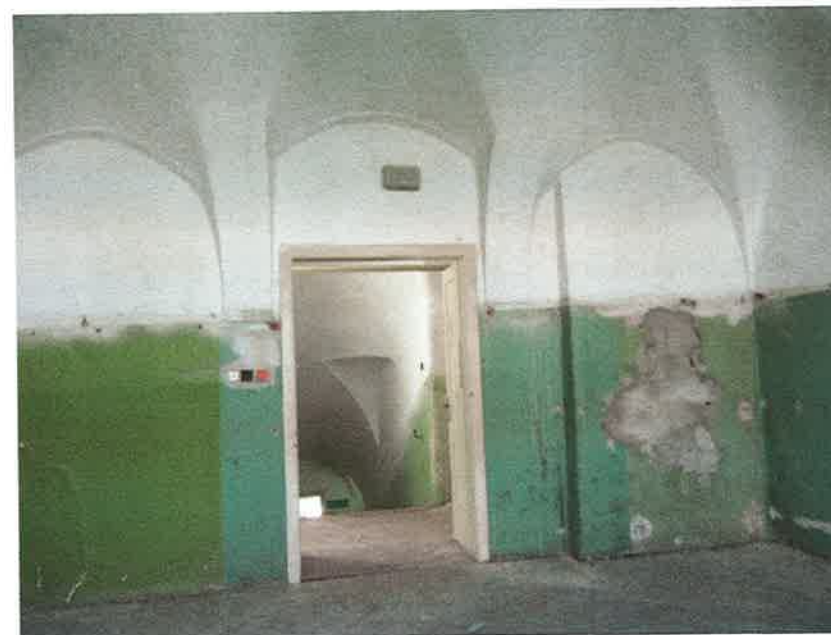
Foto č. 26 : Východné krídlo, 2.NP, m.č. 2.10, západná stena
